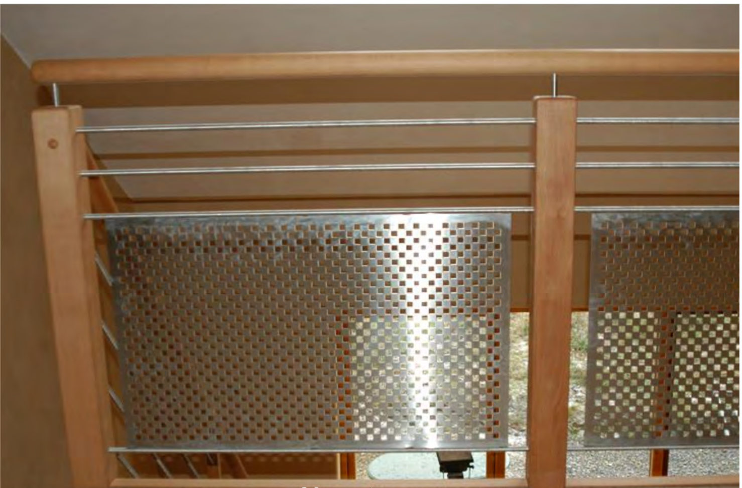
Ahorntruppe Geländer : Edelstahl mit Lochblechfüllung
